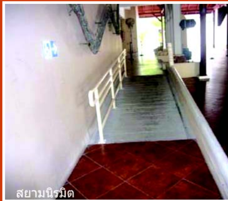
ราวจับบริเวณทางลาด
