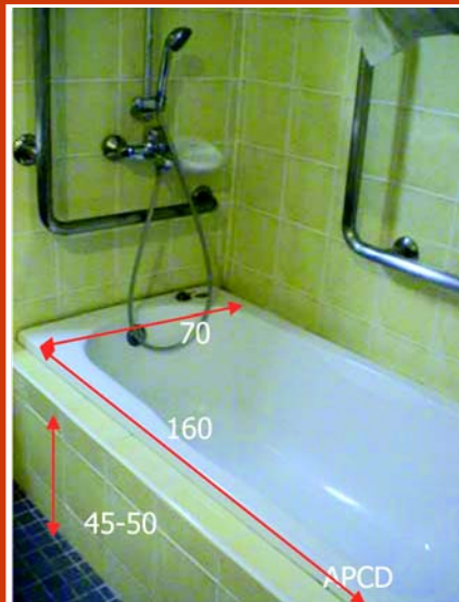
ที่อาบน้ำ แบบอ่างอาบน้ำ
